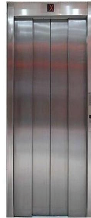
porte automatique centrale
